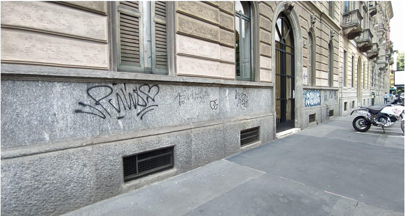
RIMOZIONE GRAFFITI PRIMA
